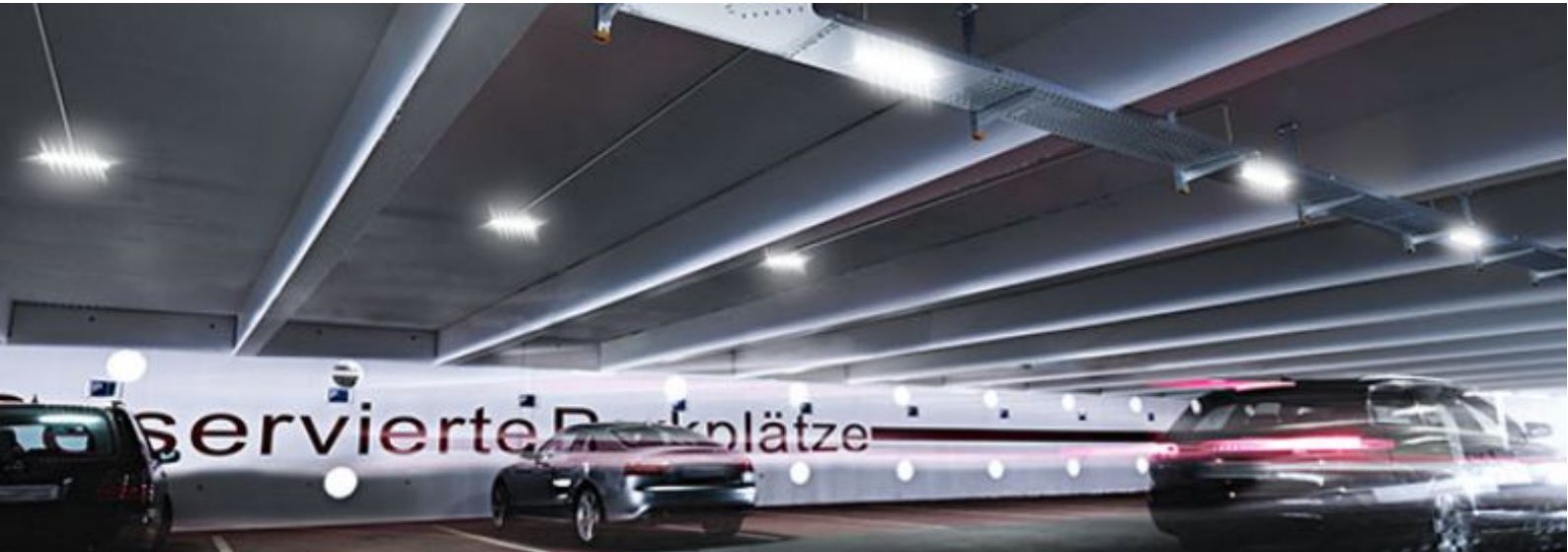
Obr. 3: Káblové žľaby s integrovaným LED osvetlením
