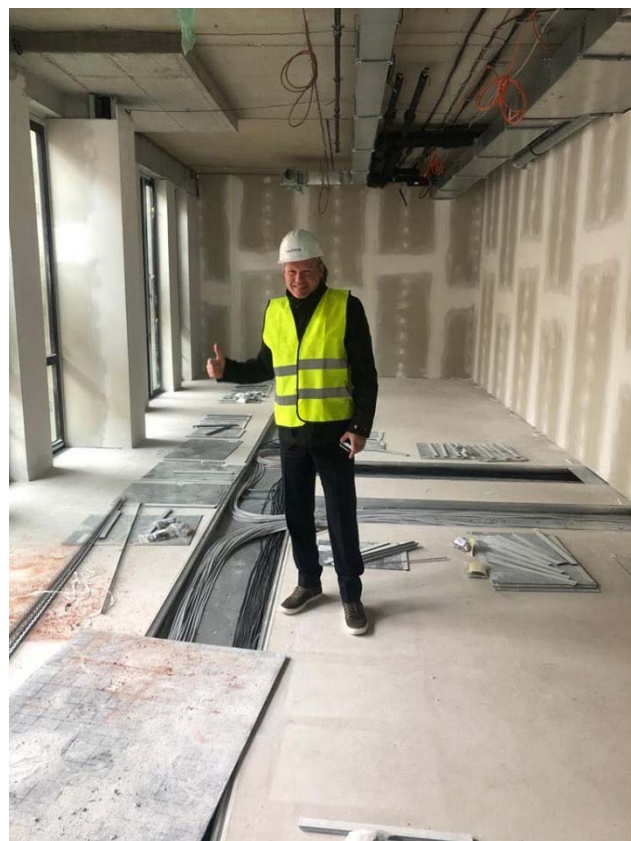
Obr. 5: Kontrola inštalácie kanálov na stavbe (Frank Metzner, OBO Bettermann Holding GmbH & Co. KG)
