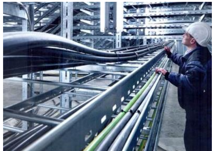
Obr.1: Káblové žľaby LG 60 v káblom priestore tepelnej elektrárne
