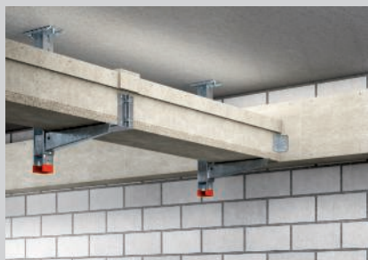
Kombinace zavěšeného protipožárního kanálu a nástěnného kanálu
